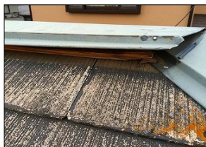
棟板金の浮き・メクレ
