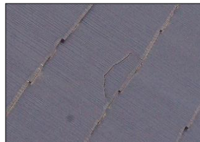
カラーベスト破損
