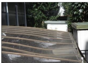
カーポートの破損
