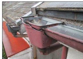
集水器の破損
